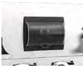
Quadro elettrico Electric panel
